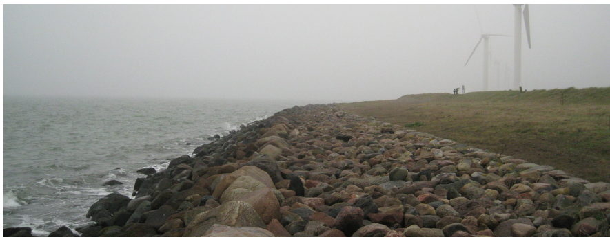
Stranden er eroderet væk ved Albuen. Diget er i dag beskyttet af en stenkastning
